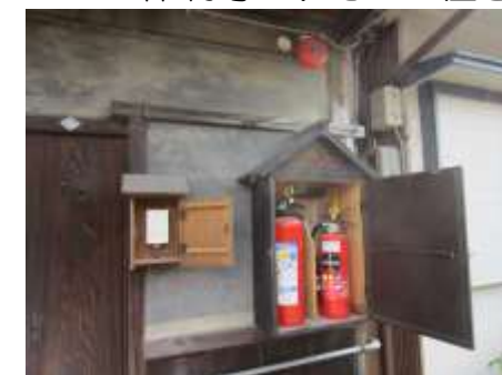
北町区の消火器と手動警報ベル
