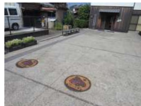
今回使用された防火水槽
